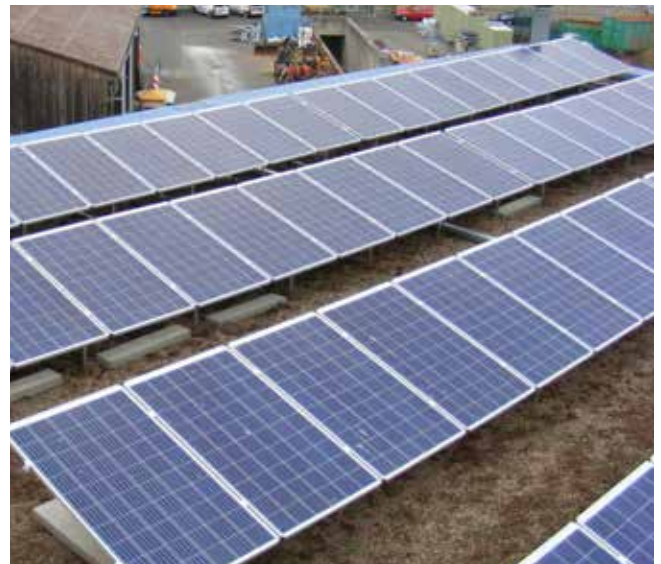
PV-Module / Foto © Klärwerk, Attermeyer
